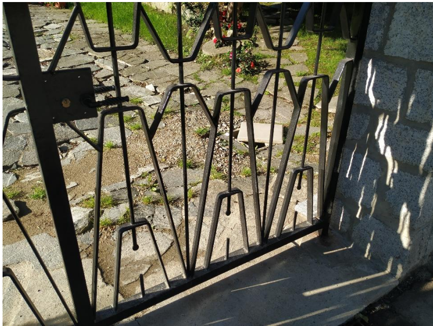
Danni causati dall'accumulo d'acqua
