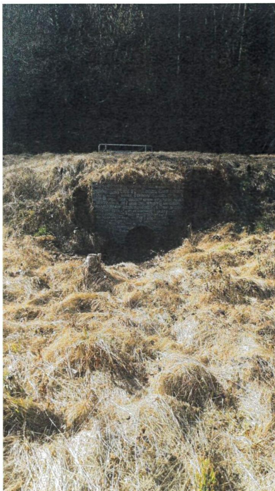
Tubazione costituente l'attraversamento di Via per Crevacuore intervento 2
